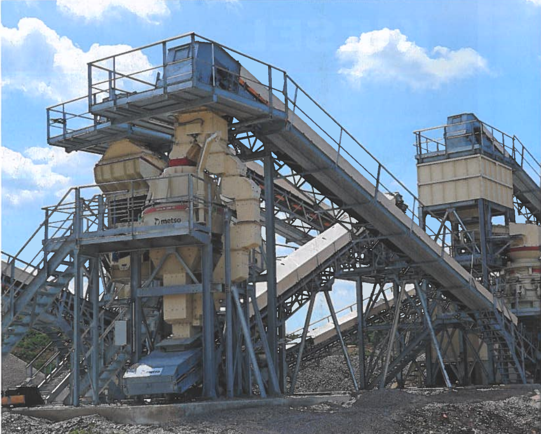
Im Vordergrund der Nordplant Barmac B6150SE Vertikalprallbrecher, dahinter der Nordplant HP200 Kegelbrecher.
